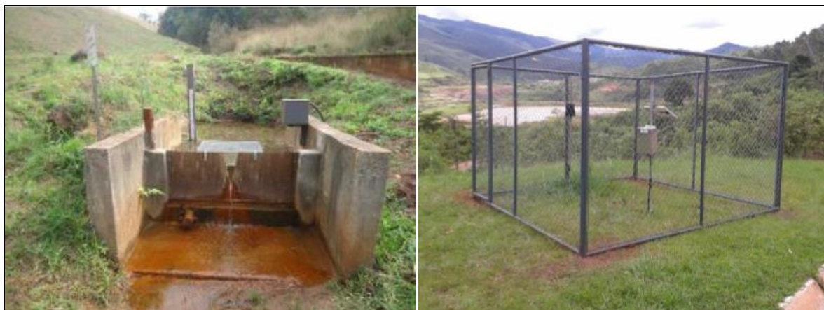
Figura 4-11 - Medidor de vazão e pluviômetro instalados em mina (Fonte: O autor, 2015).
